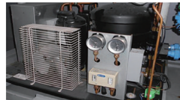
R12 試驗室採用變頻控制技術，不僅有效降低電力消耗與運行成本，也進一步提升產品研發效率。
